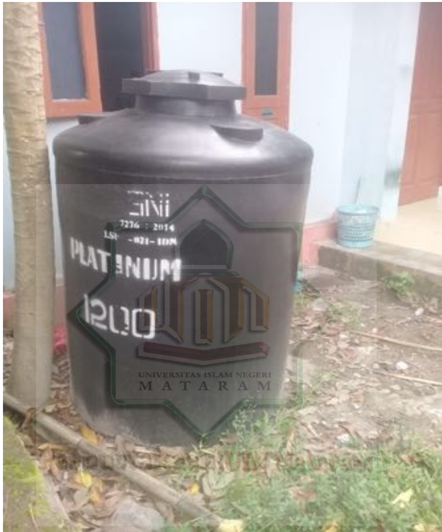
Tandon, digunakan untuk menampung air
